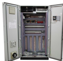
Системы противоаварийной защиты (СПАЗ)
