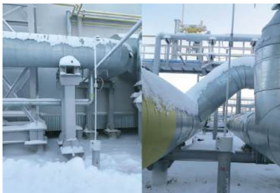
Рис. 1 Дожимная компрессорная станция
