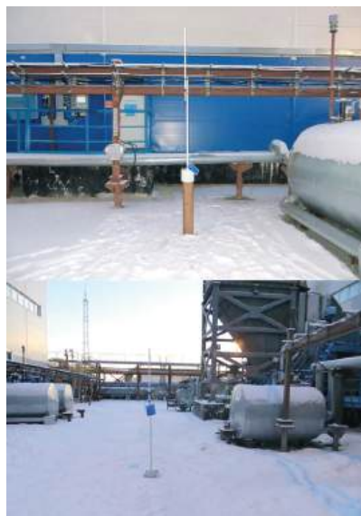
Рис. 2 Дожимная компрессорная станция
